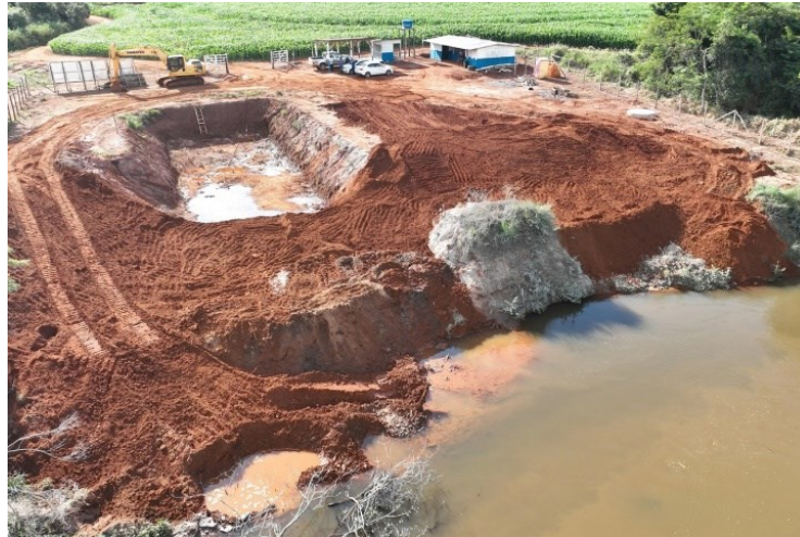
Figura 9 – Construção do canal de entrada de água da captação do rio Ligeiro, em Cianorte – PR
