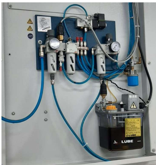
Figura (20) - Reservatório de lubrificação automática.
