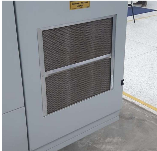
Figura (27) - Filtros e ventiladores do painel elétrico
