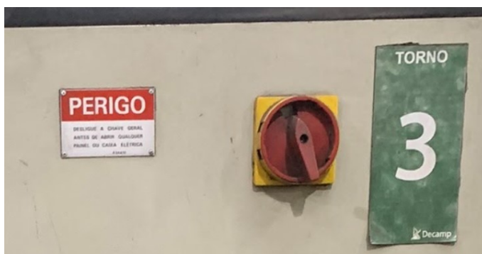
Figura 8 – Chave geral de energia e aviso de perigo.
