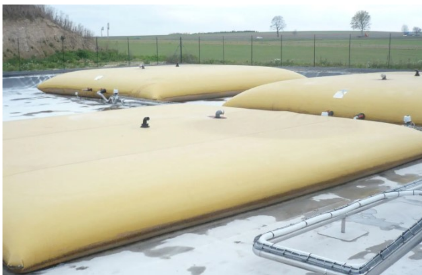
Figura 44 – Tanque para armazenamento de biofertilizante líquido
