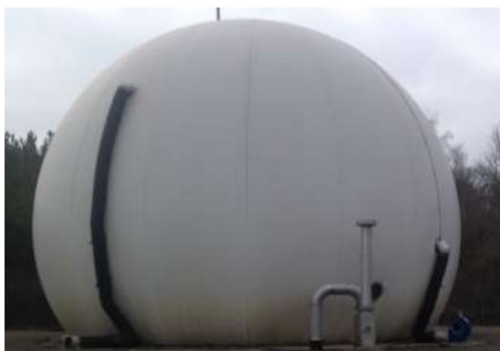
Figura 12 – Gasômetro de lona utilizado para armazenamento de biogás
