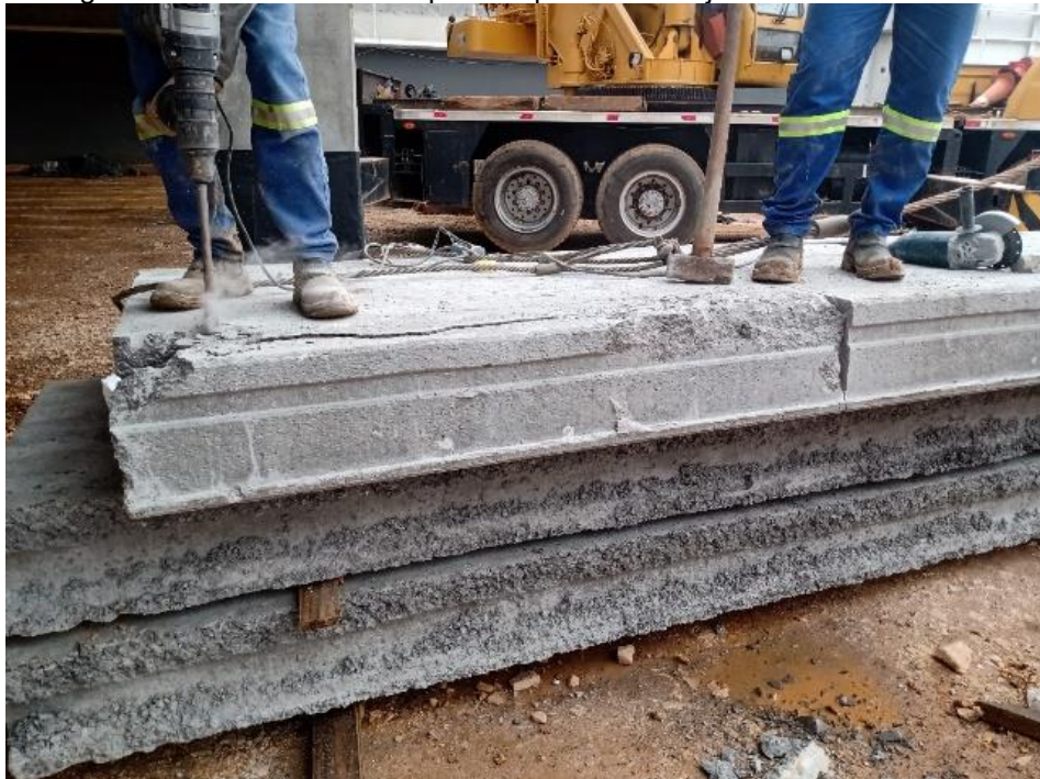
Figura 12 - Falta de encaixe para os pilares nas lajes alveolares
