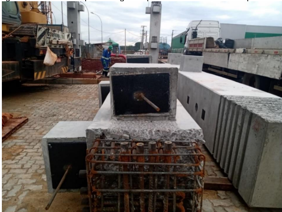
Figura 14 - Inseto de apoio da viga mal posicionado no consolo do pilar
