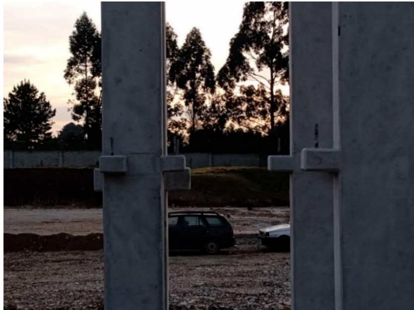
Figura 25 - Consoles desnivelados e desalinhados
