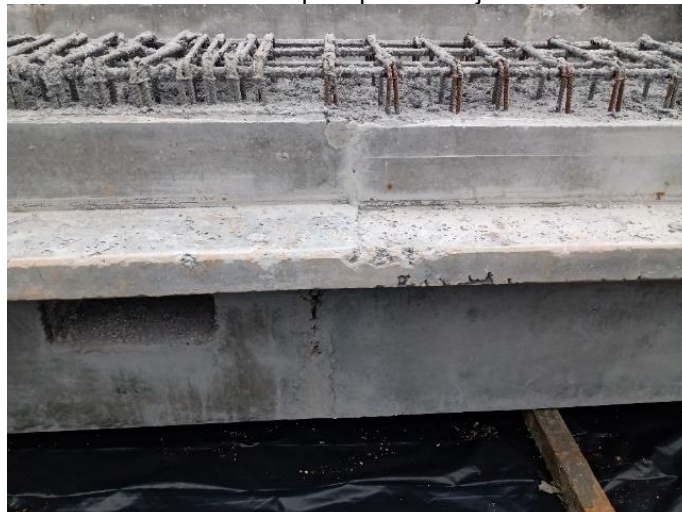
Figura 10 - Desnível da aba de apoio para as lajes alveolares na viga pré-moldada
