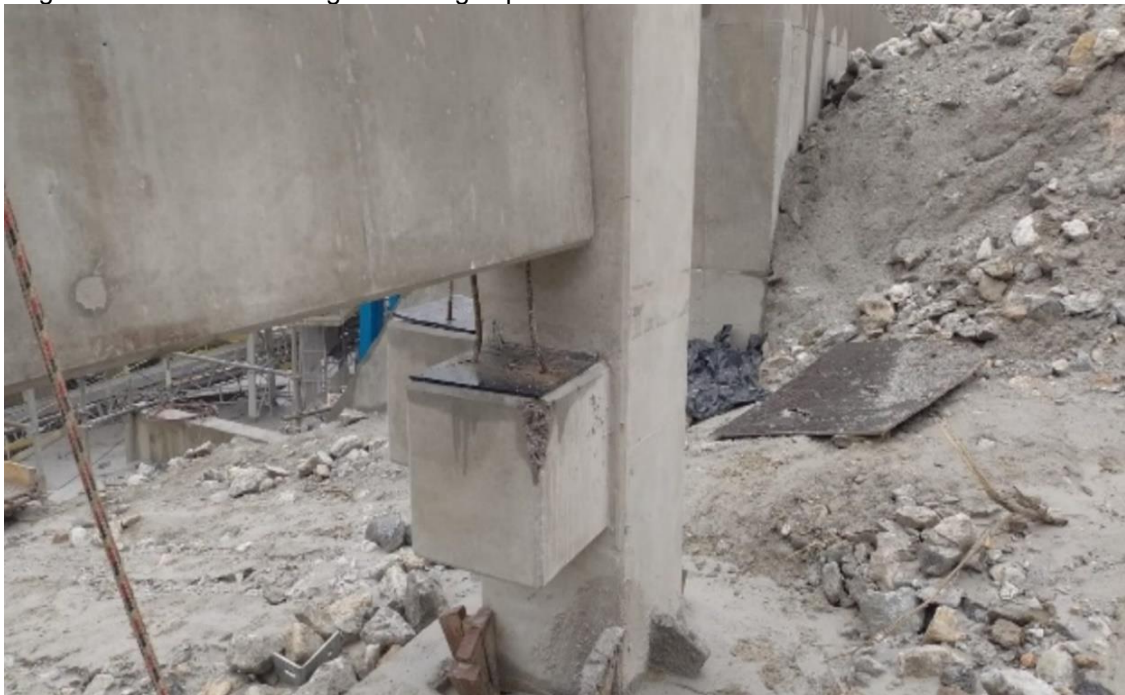
Figura 22 - Furo de montagem das vigas posicionados em local incorreto
