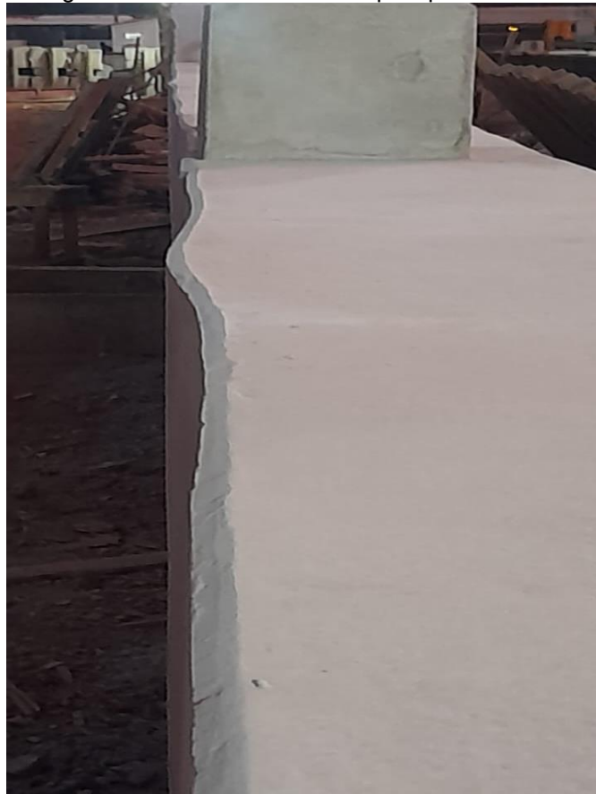
Figura 18 - Desalinhamento do pilar pré-fabricado
