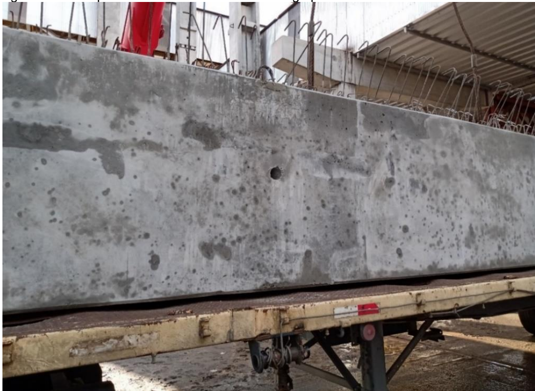
Figura 24 - Estuque de acabamento mal feito na viga pré-fabricada
