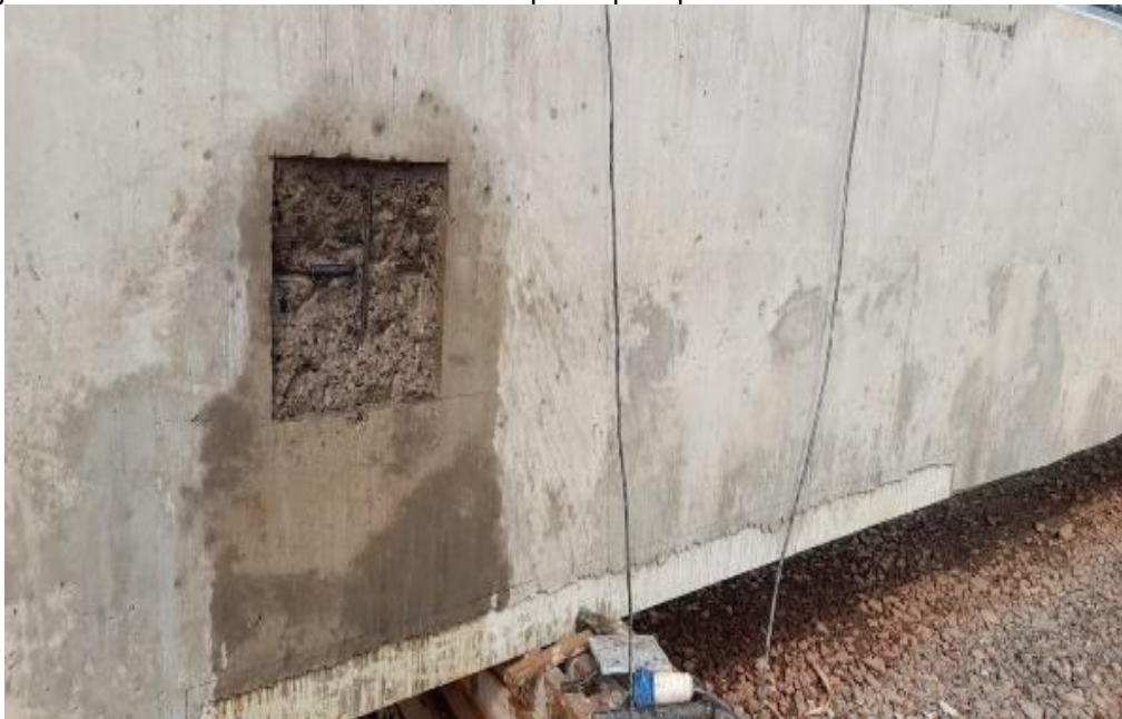
Figura 20 - Falta de inserto metálico no corpo do pilar pré-moldado
