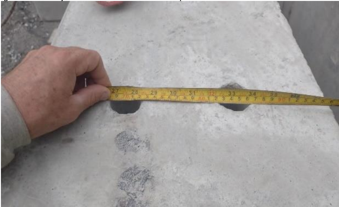
Figura 23 - Correção dos furos dos chumbadores posicionados em local incorreto.
