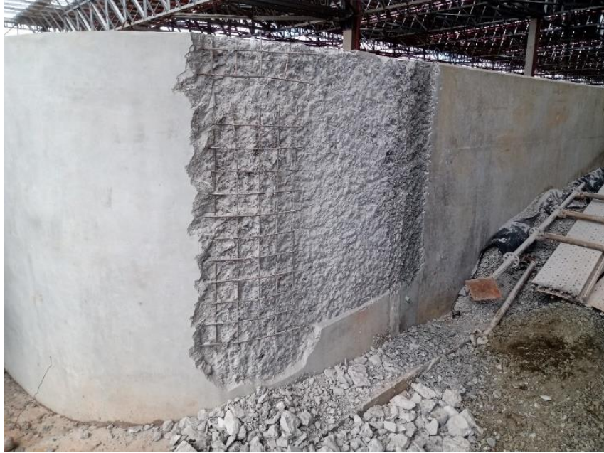
Figura 17 - Correção do desaprumo da parede de contenção
