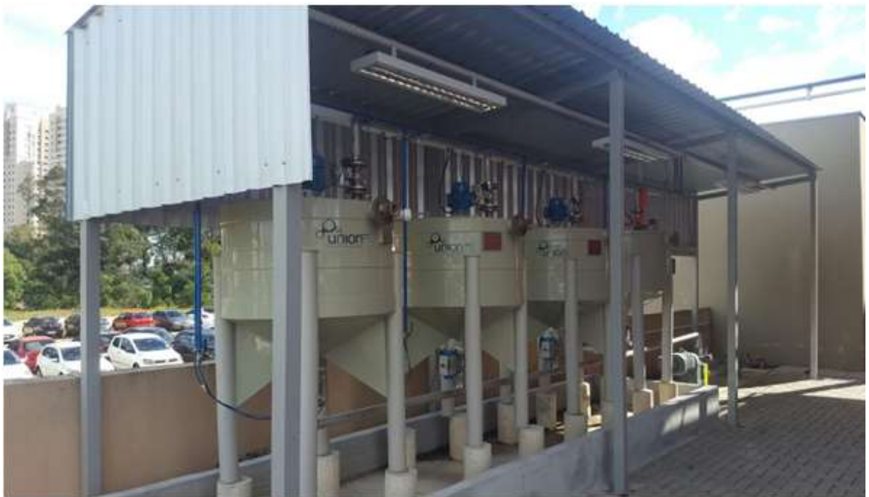
Figura 3.3 – Reservatórios de fluidos da unidade experimental instalados nas dependências na UTFPR
