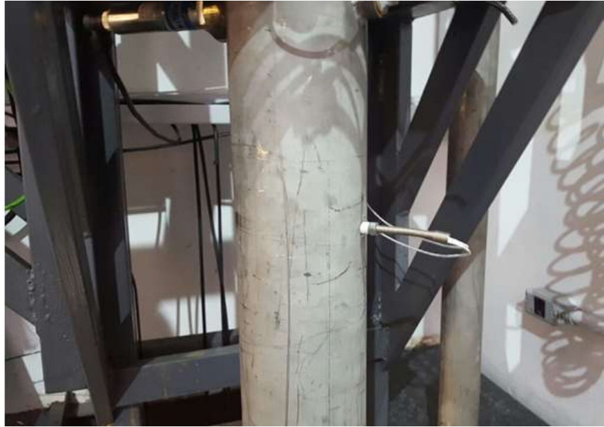
Figura 3.6 – Termoresistor PT100 instalado no poço.
