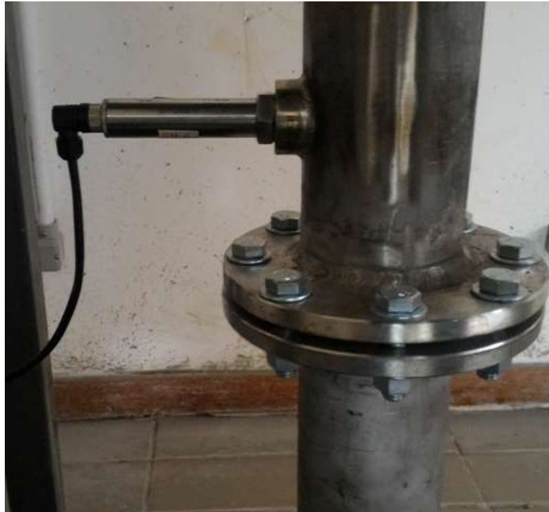
Figura 3.5 – Transdutor de pressão P3 instalado no poço da unidade experimental.
