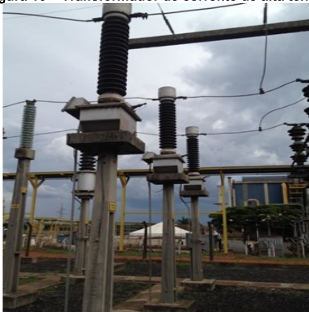
Figura 10 – Transformador de corrente de alta tensão
