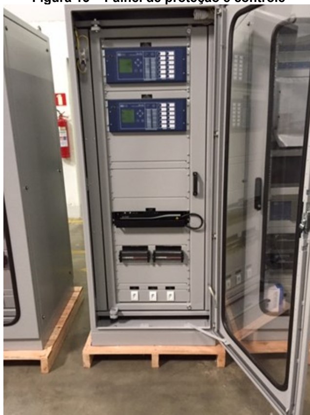
Figura 13 – Painel de proteção e controle
