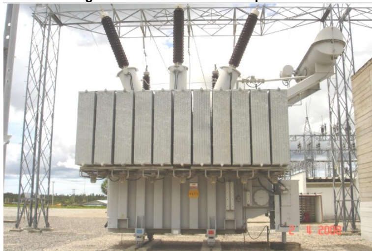
Figura 8 – Transformador de potência
