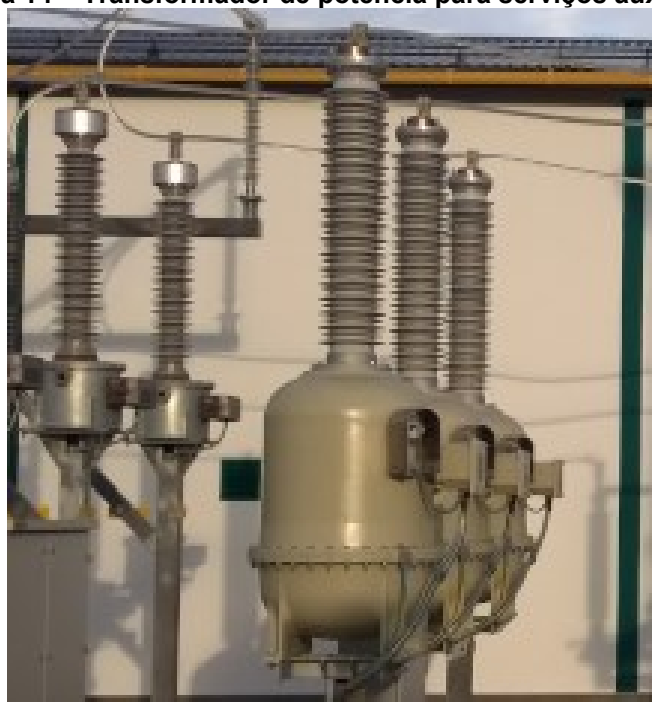
Figura 14 – Transformador de potência para serviços auxiliares
