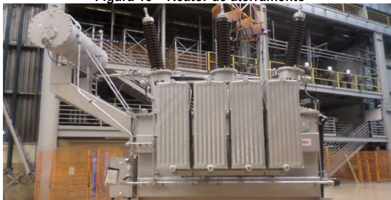
Figura 15 – Reator de aterramento
