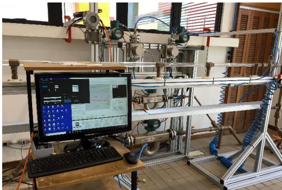
Figura 3-7: Sistema de controle da planta do NUEM com o supervisório e instrumentação ao fundo
