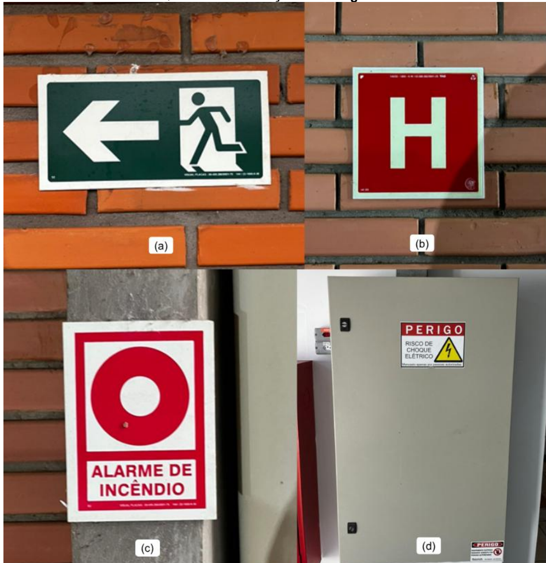
Quadro 1: Sinalização de emergência
