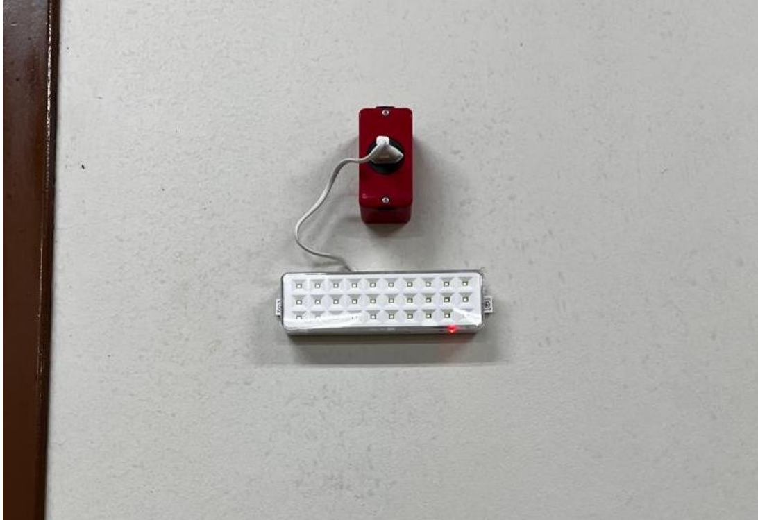
Imagem 3: Luminária de bloco autônomo
