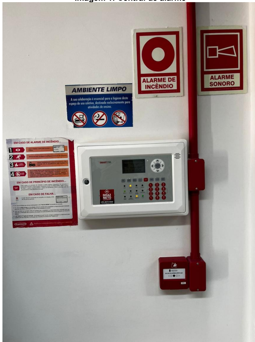
Imagem 1: Central de alarme
