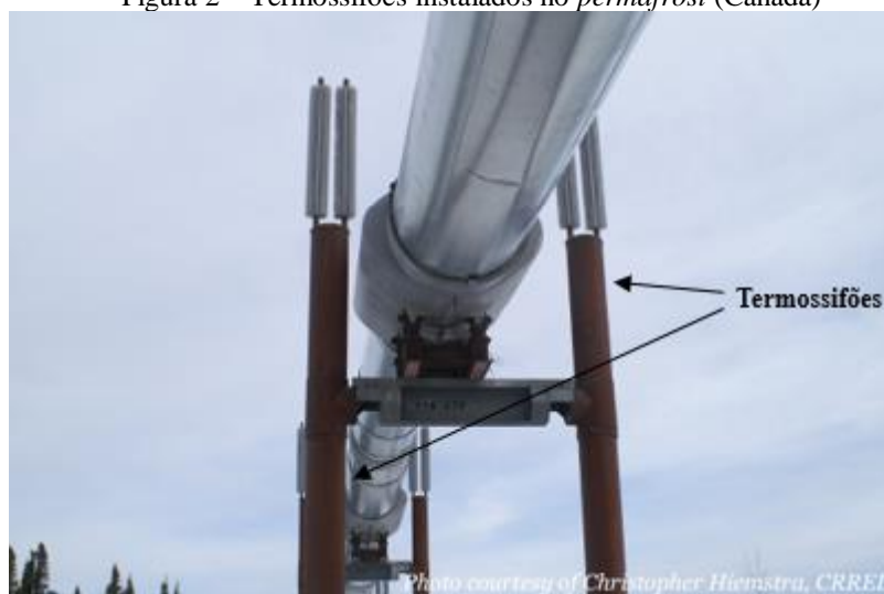
Figura 2 – Termossifões instalados no permafrost (Canadá)
