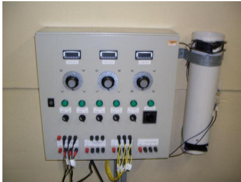
Figura 29 – Painel de comando e carga resistiva.
