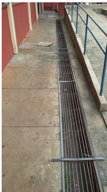
Figura 89 – Grelhas danificadas Fonte: Autoria Própria
