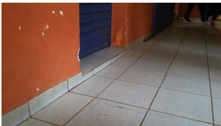
Figura 62 – Degrau entre Bloco de Salas 1 e secretaria Fonte: Autoria Própria
