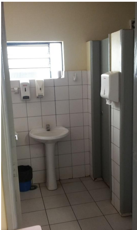
Figura 59 – Sanitário Masculino Fonte: Autoria Própria
