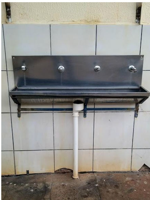
Figura 87 – Bebedouro do Refeitório Fonte: Autoria Própria
