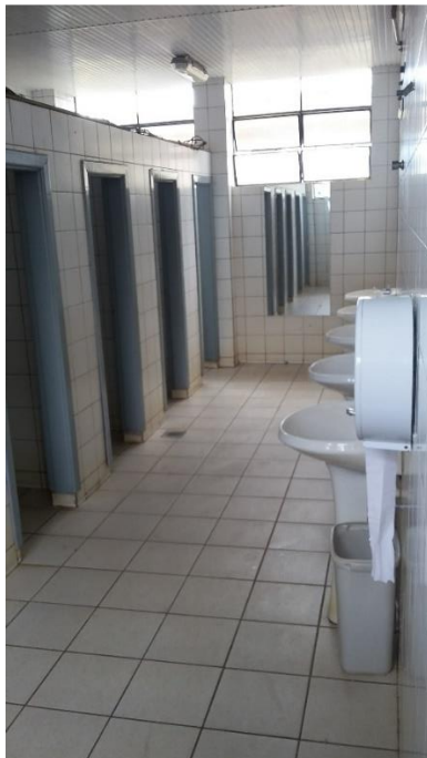
Figura 65 – Situação do sanitário do Bloco de Salas 1 Fonte: Autoria Própria
