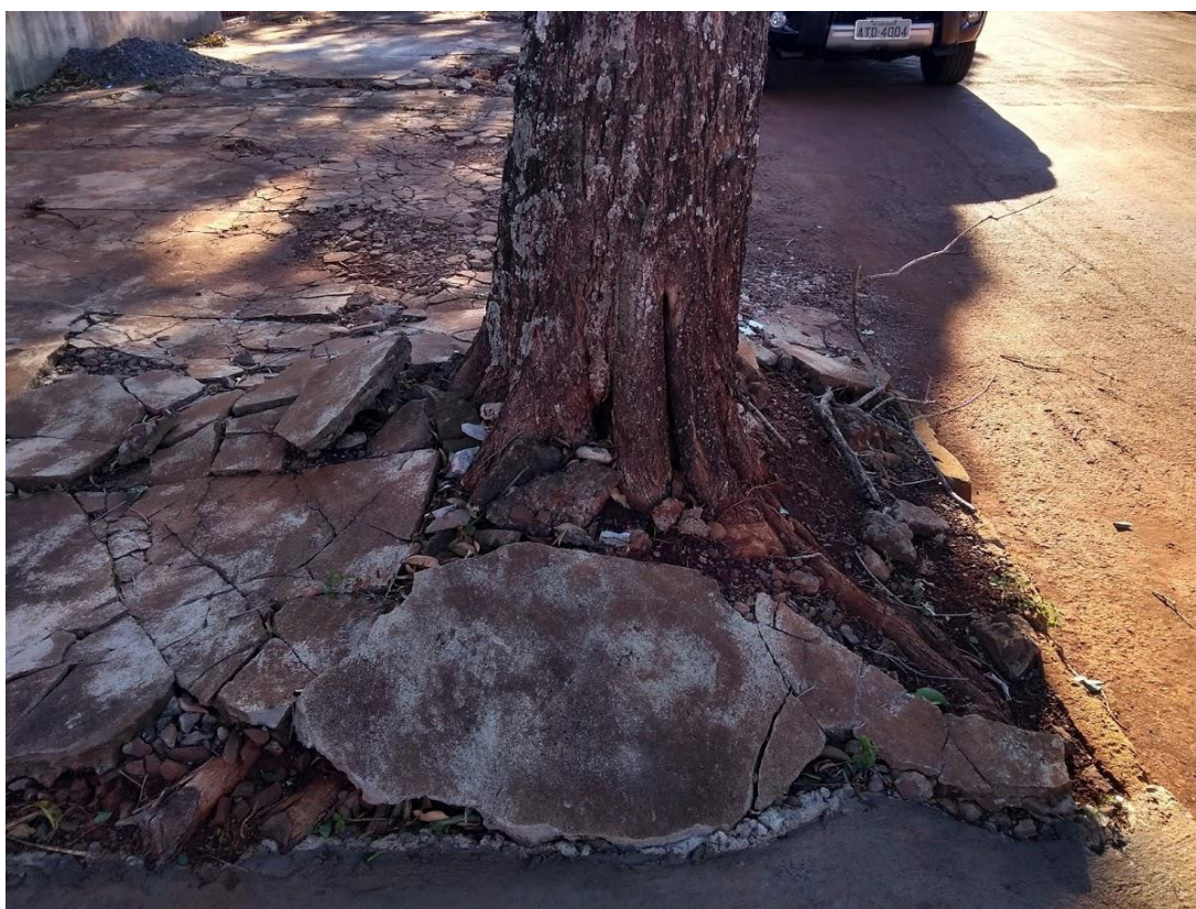
Foto 1: Danos ao calçamento devido ao levantamento de raiz.
