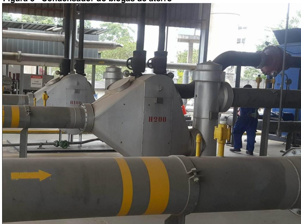
Figura 8– Condensador do biogás de aterro
