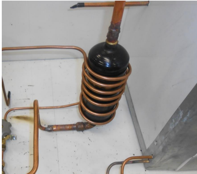
Figura 16 - Tanque acumulador. Fonte: Autoria própria.
