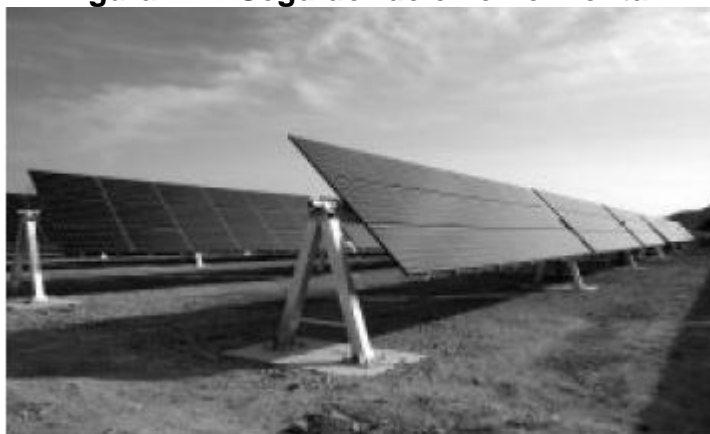
Figura 12 – Seguidor de eixo horizontal.
