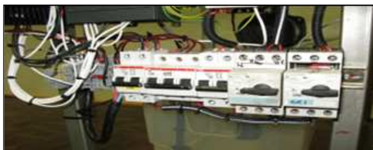
Figura 26 – Disjuntores Fonte: Autoria Própria
