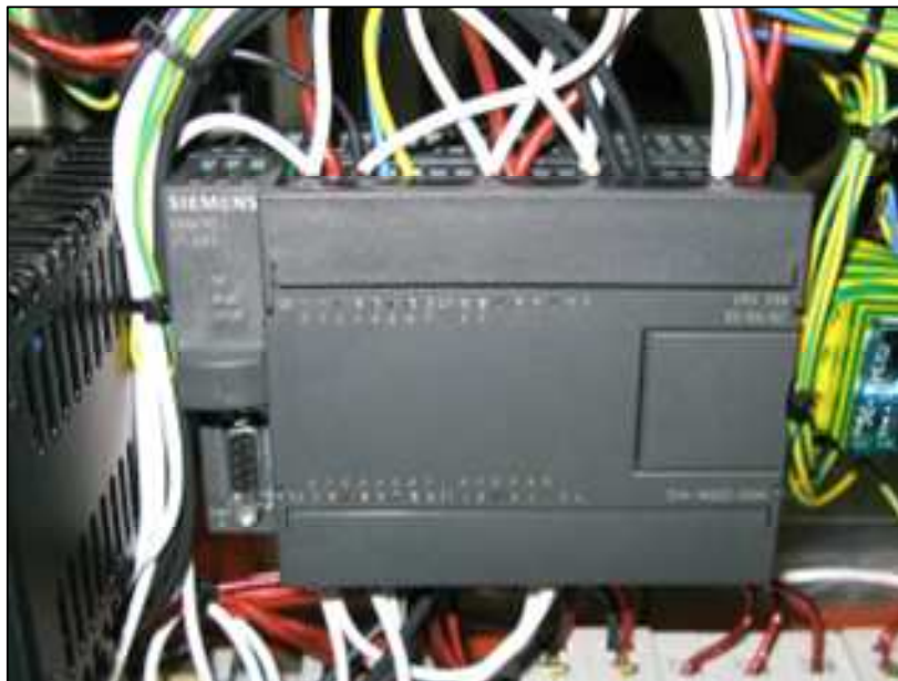
Figura 29 – Controlador Lógico Programável - CLP Fonte: Autoria Própria
