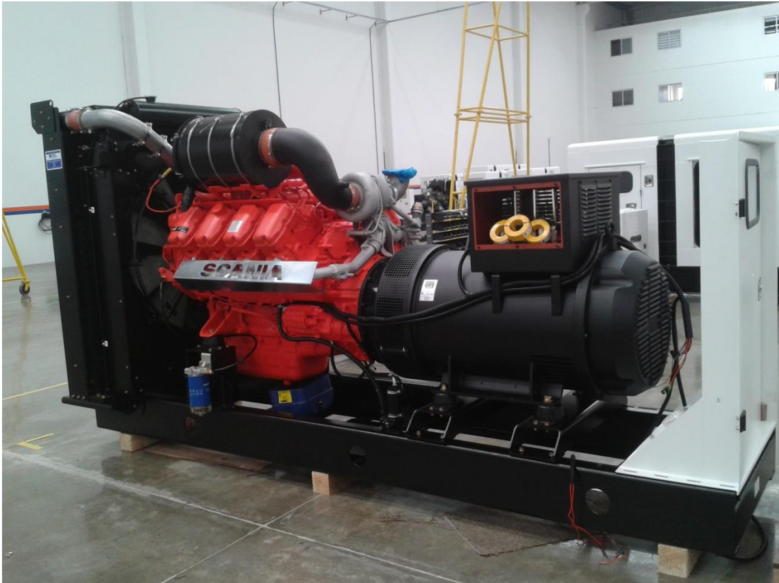
Figura 6 - Grupo Gerador Fonte: Autor (2015)
