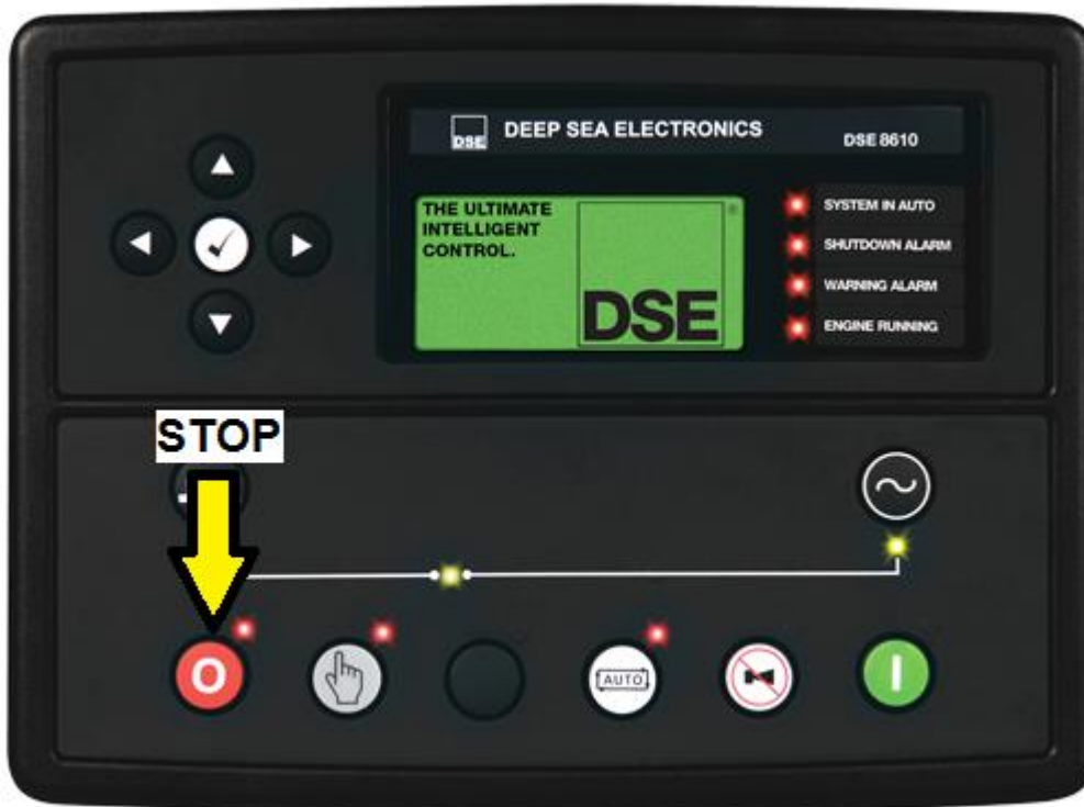
Figura 42 - Módulo DSE8660 indicando a tecla STOP Fonte: Autor (2015)
