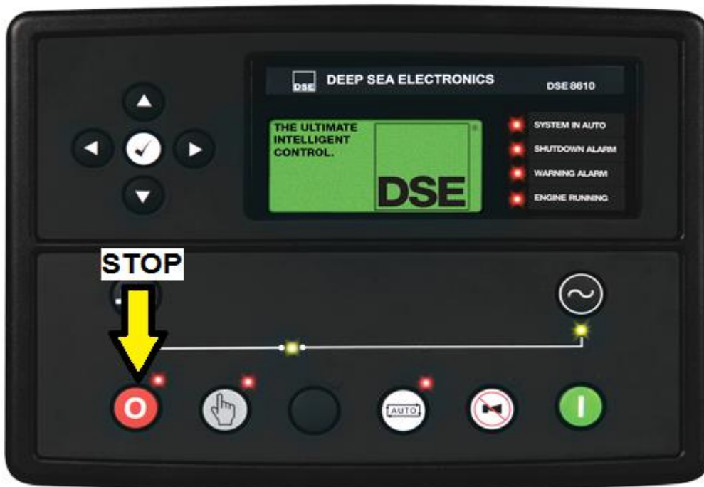
Figura 40 - Módulo DSE8610 indicando a tecla STOP Fonte: Autor (2015)
