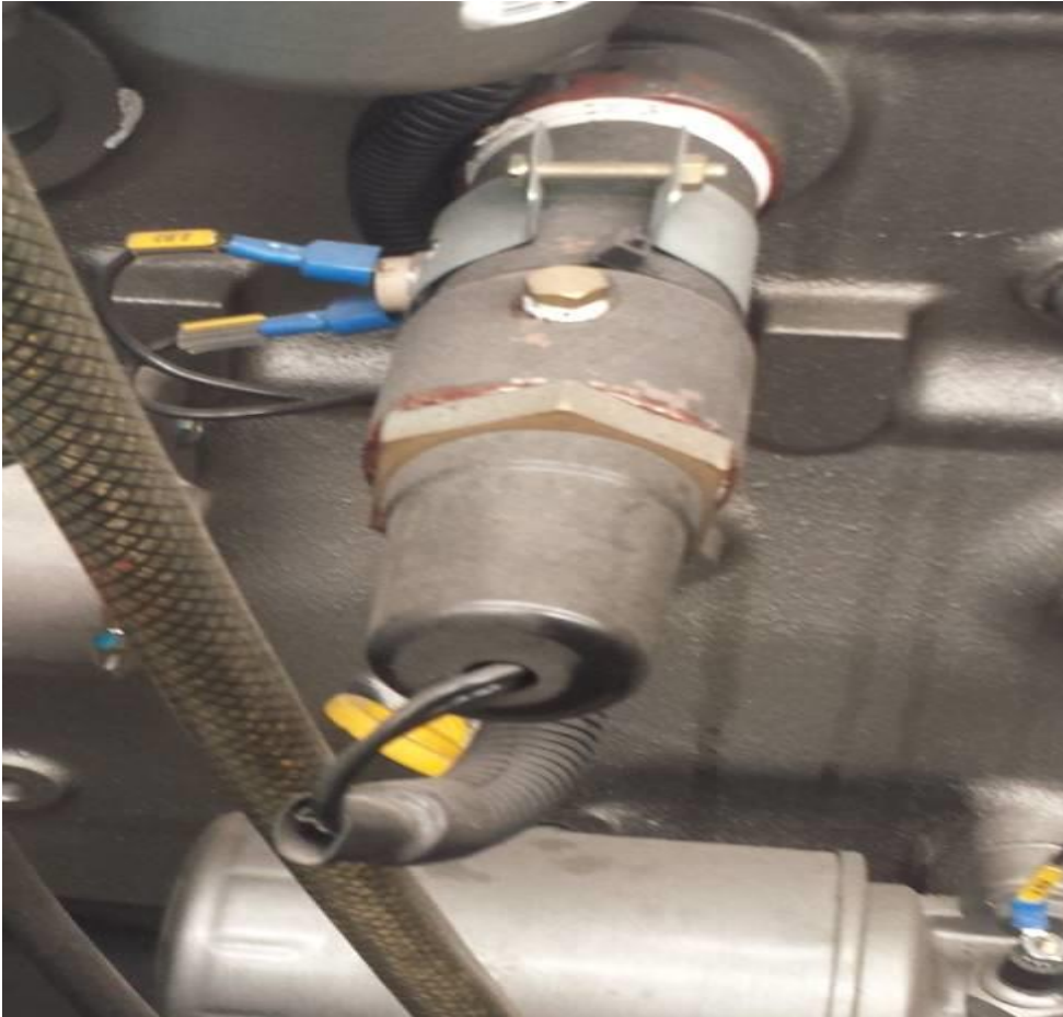
Figura 17 Sistema de Pré-aquecimento do Motor Fonte: Autor (2015)
