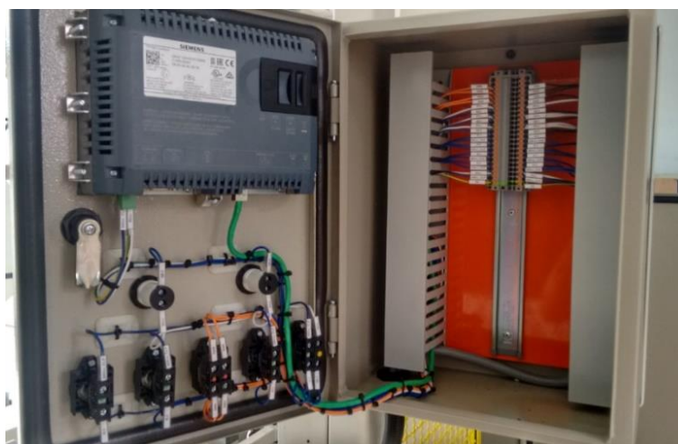
Figura 22 - Vista interna do painel da IHM.
