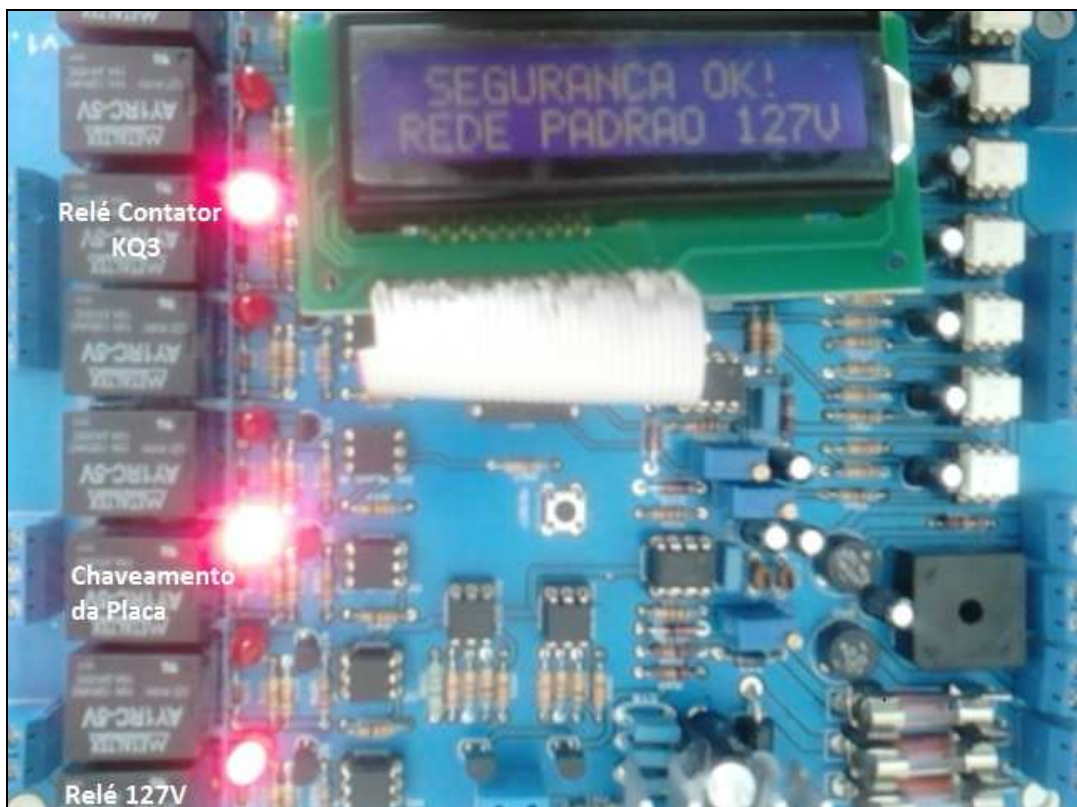
Figura 33 – Acionamento dos relés em tensão de 127 Vca. Fonte: Autoria própria.
