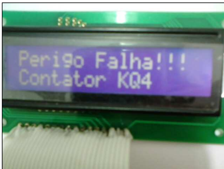
Figura 28 – Mensagem de erro indicando o contator que se encontra com defeito.
