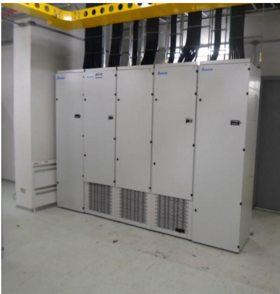
Figura 15- Fonte Indoor 3600A, -48V CC, instalada em uma central de Comutação. São Paulo. Fonte: Autoria própria.
