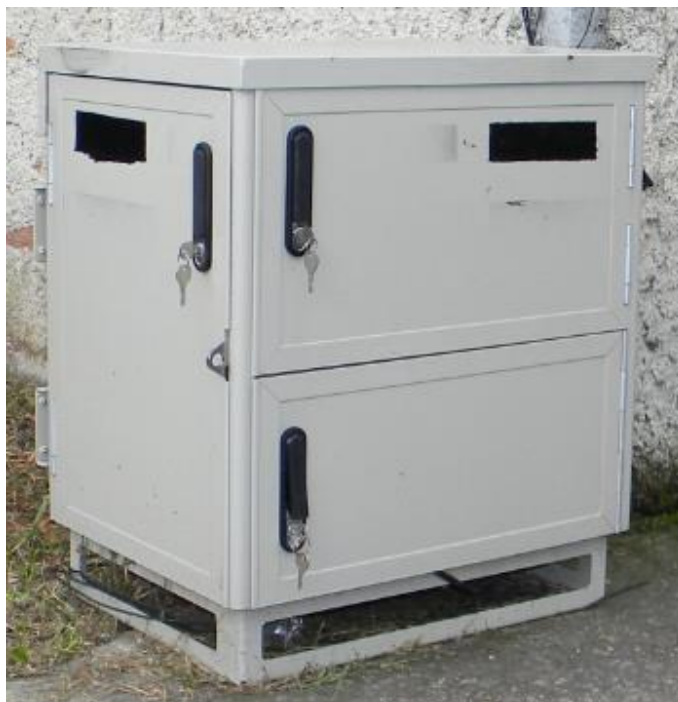
Figura 27– Gabinete outdoor utilizado para abrigo do sistema Fonte: Autoria própria
