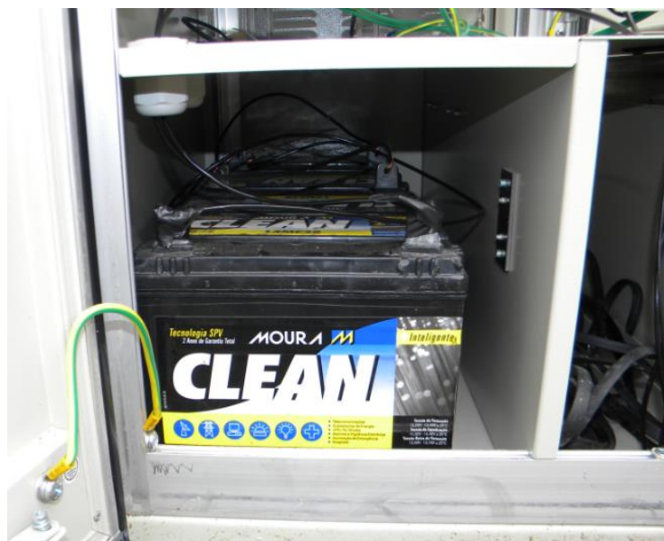
Figura 34- Banco de baterias 4 elementos 48V 30A Fonte: Autoria própria
