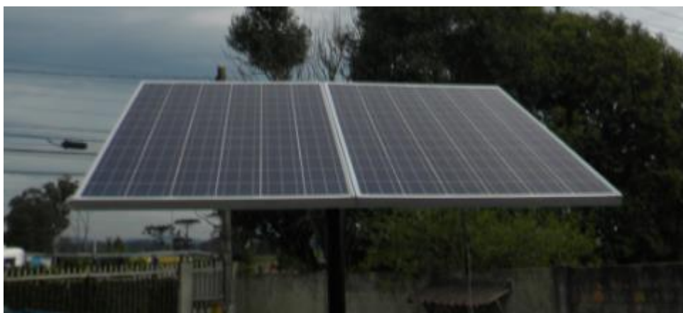
Figura 37– Disposição dos painéis fotovoltaicos.
