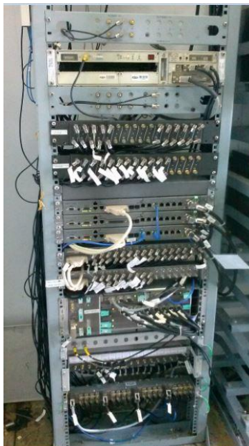
Figura 25- Rack de equipamentos conectados a uma fonte indoor -48V Fonte: Autoria própria.
