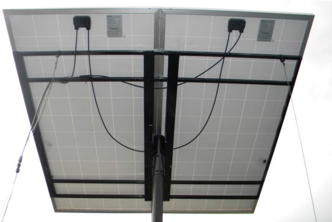
Figura 30– Moldura dos painéis fotovoltaicos Fonte: Autoria própria
