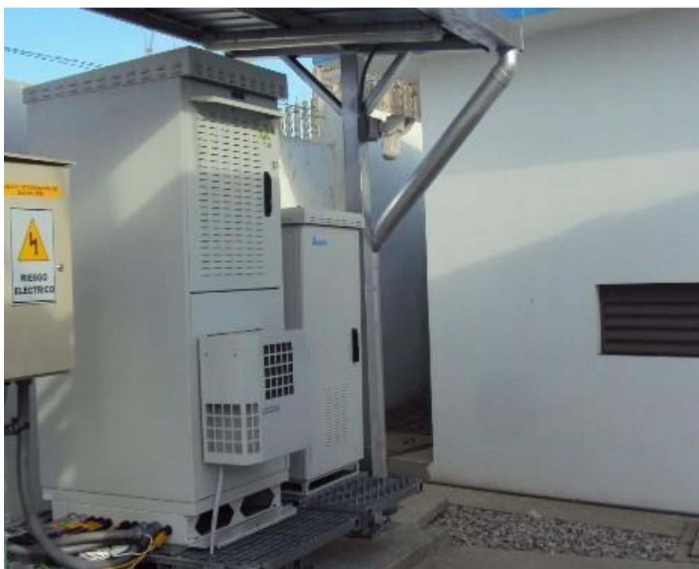
Figura 14- Fonte 300A, -48V CC. Instalada em um site Outdoor. Guayaquil - Equador. Fonte: Autoria própria.
