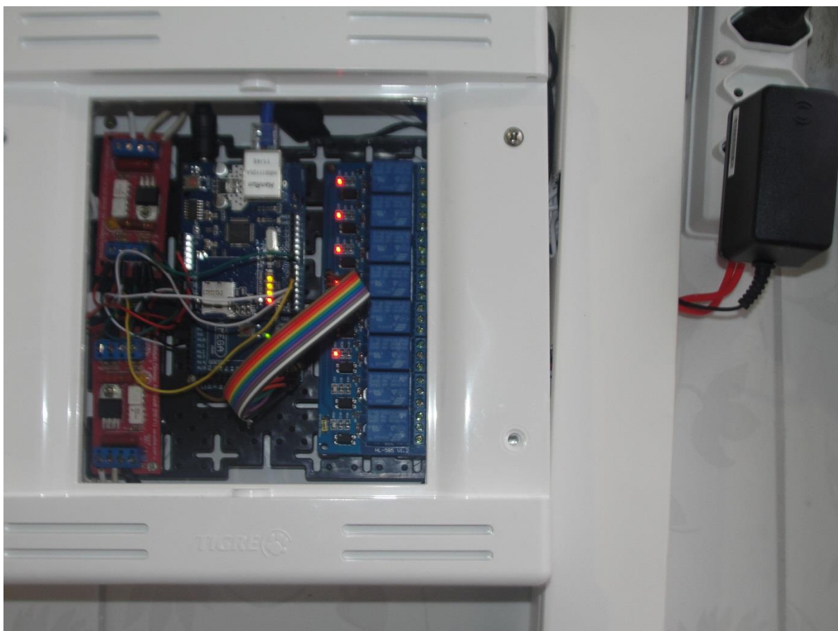
Figura 17 – Arduino instalado na residência.
