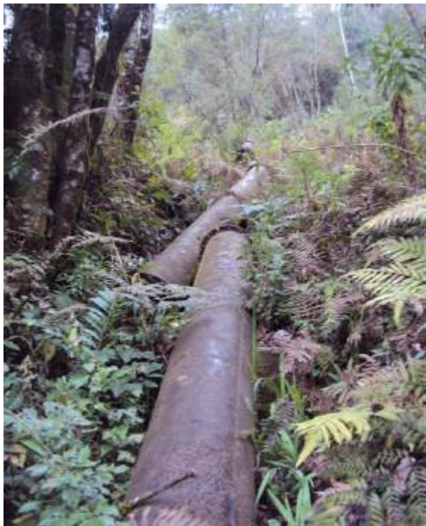
Figura 32 - Conduto forçado Fonte: Própria (2015)
