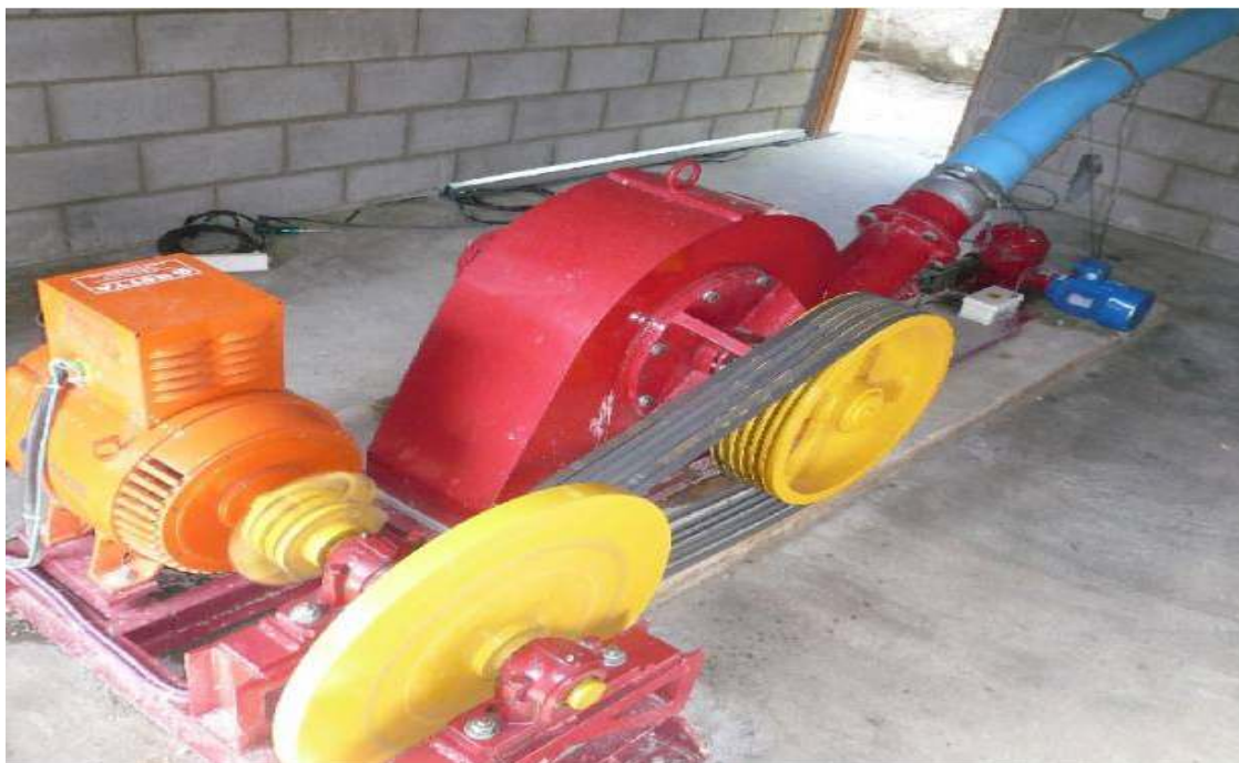
Figura 13 - MCH com Turbina Pelton de eixo vertical Fonte: Beta hidroturbinas.
