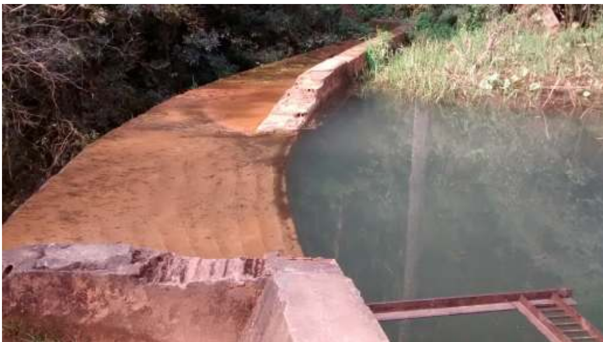
Figura 27 - Reservatório MCH de Rio Branco do Sul Fonte: Própria (2015)
