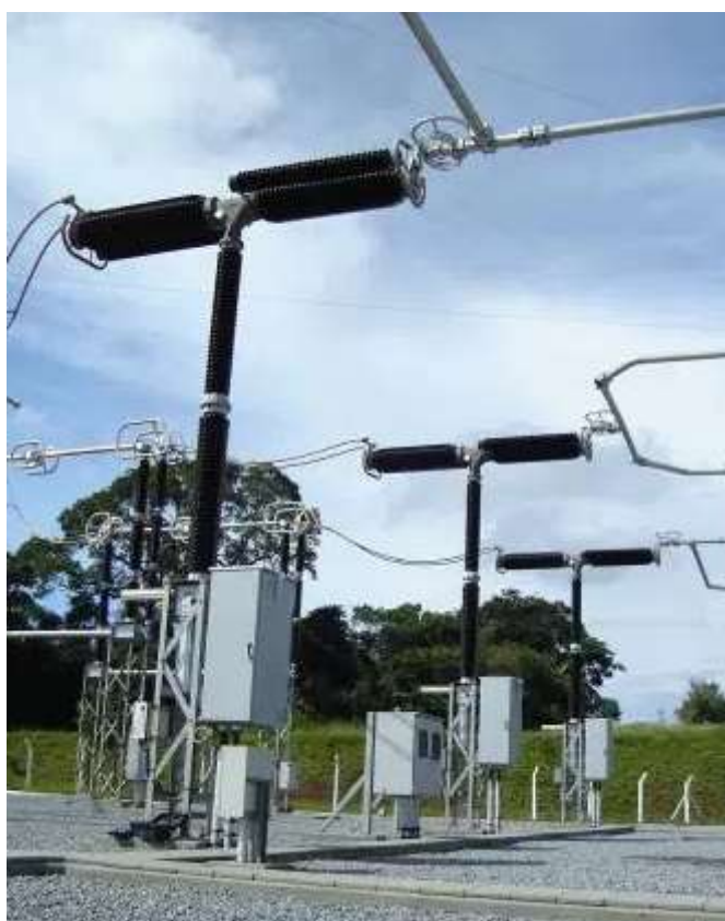
Figura 16 – Disjuntor de alta tensão.
