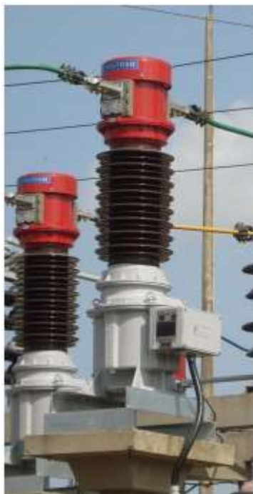
Figura 18 - Transformador de corrente
