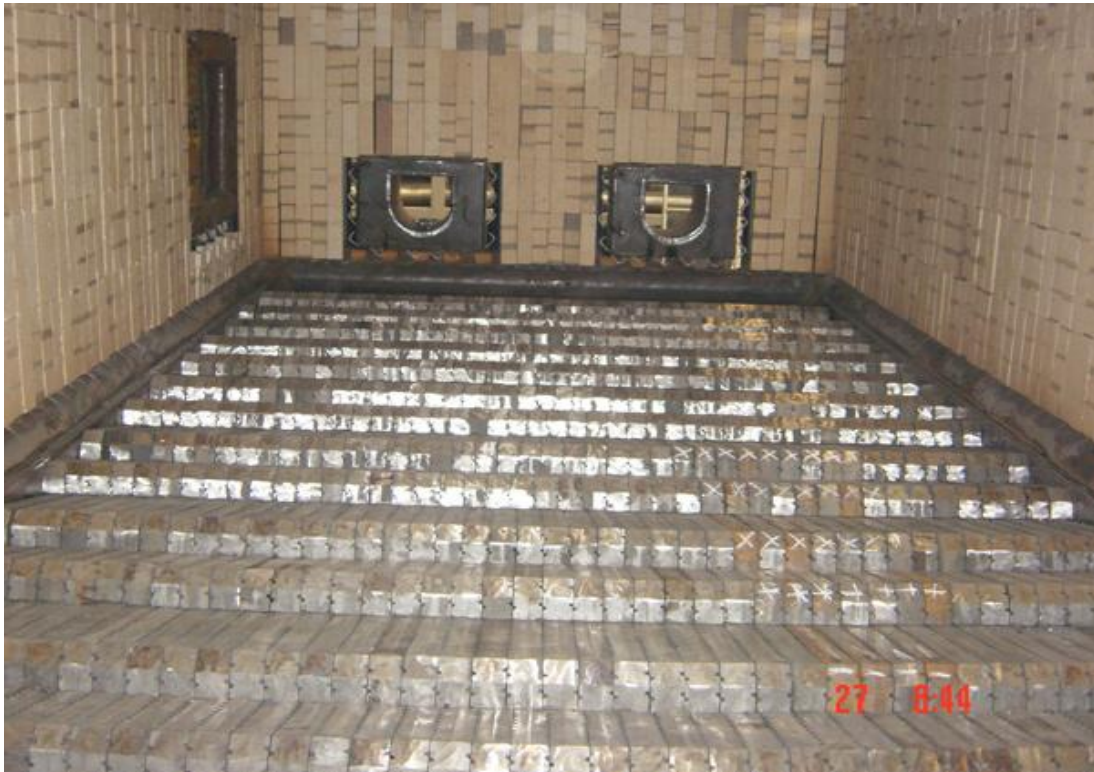
Figura 29 – Interior de uma caldeira com grelha. Fonte: Fimaco do Brasil, 2013.
