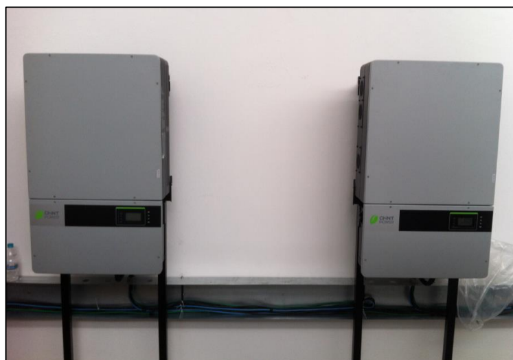
Figura 19 – Inversores de 20 kW para conexão dos módulos FV ao SFVCR Fonte: Autoria própria
