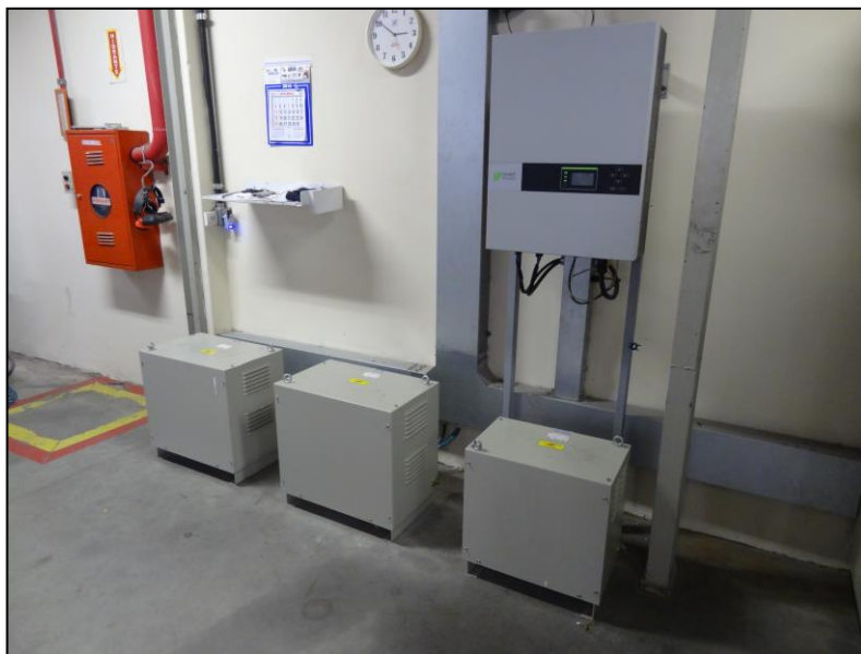
Figura 22 – Transformadores isoladores trifásicos Fonte: Autoria própria
