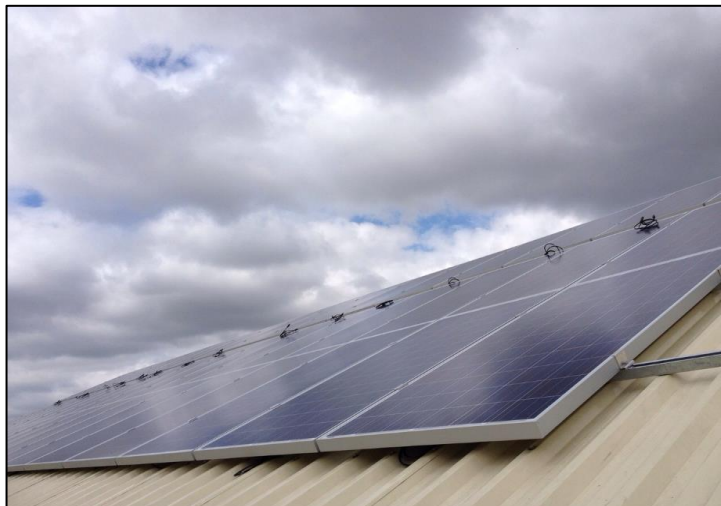
Figura 17 – Módulos fotovoltaicos instalados no barracão Fonte: Autoria própria
