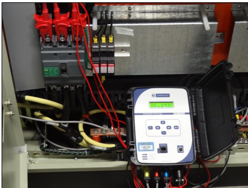
Figura 25 – Instalação do analisador de energia no disjuntor de entrada no quadro de distribuição geral Fonte: Autoria própria
