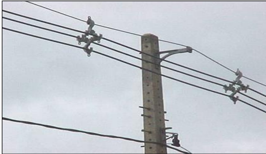
Figura 4 - Rede de Distribuição Aérea Compacta
