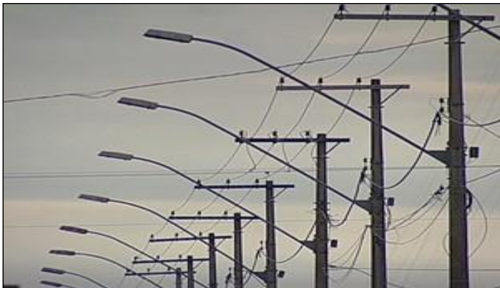
Figura 2 - Rede de Distribuição Aérea Convencional
