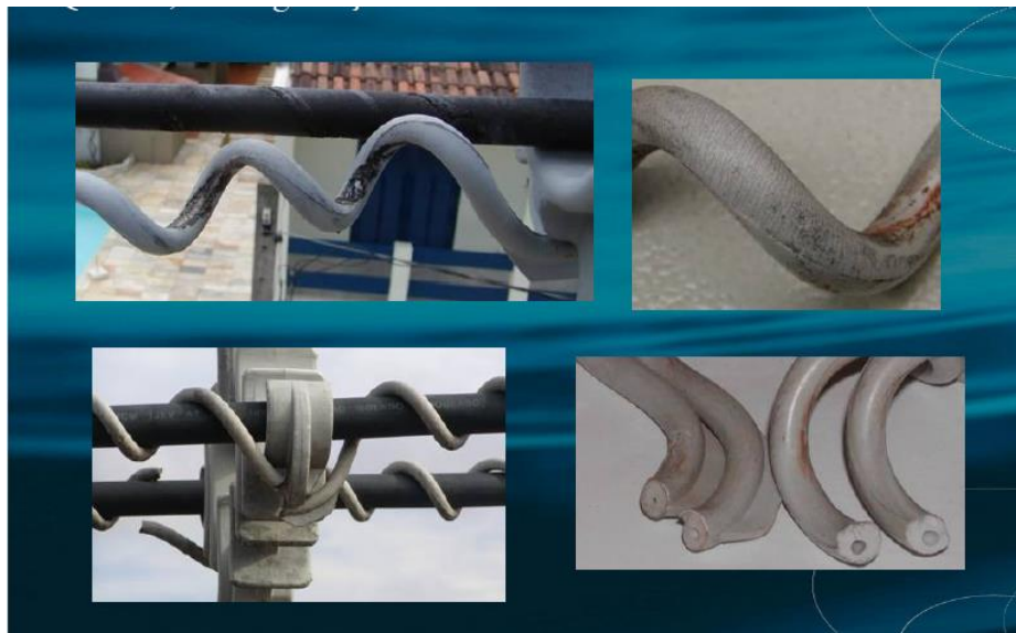
Figura 11 – Problemas de quebra e trilhamento nos fixadores
