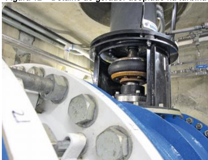
Figura 12 – Detalhe do gerador acoplado na turbina
