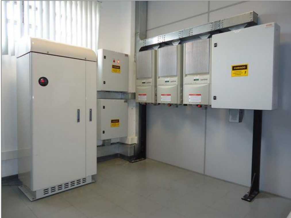
Figura 20 - Inversores Xantrex instalados na ELCO.
