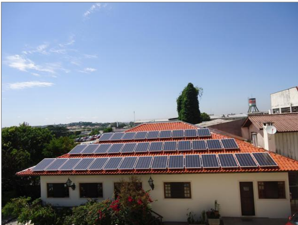
Figura 19 - Paineis fotovoltaicos ELCO.
