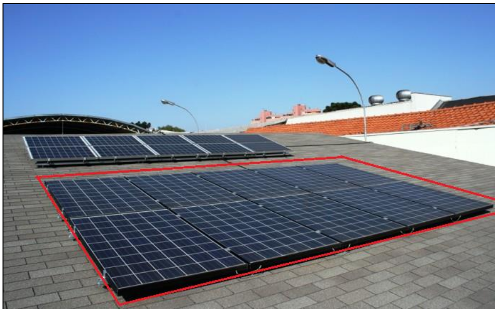
Figura 15 - Painel fotovoltaico do EV.
