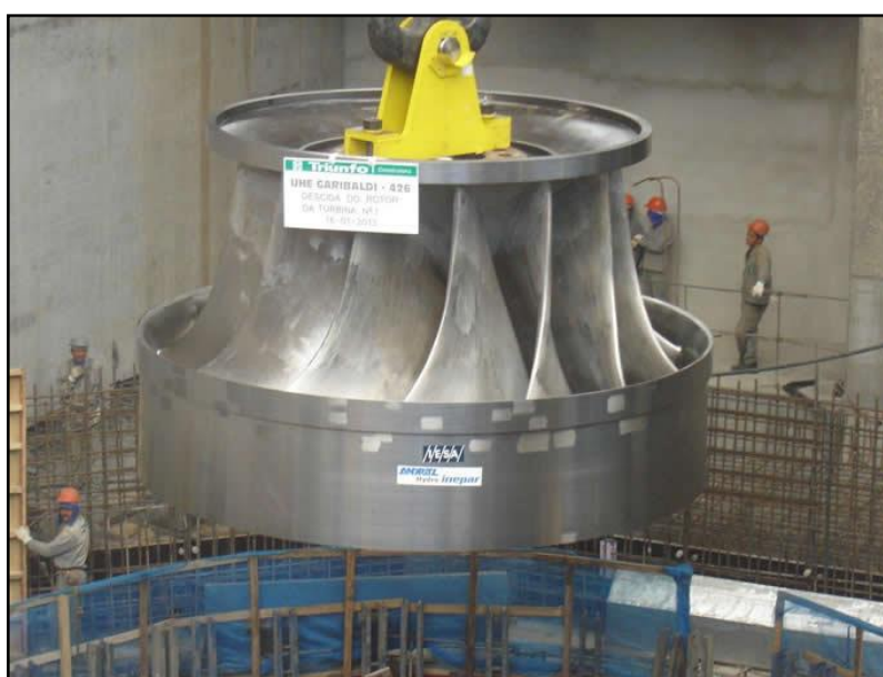
Figura 11–descida do Rotor da Turbina Tipo Francis na Unidade Geradora nº 01 da UHE Garibaldi ( http://www.inepar.com.br/noticias/UHE_Garibaldi_23_01_13.html ).
