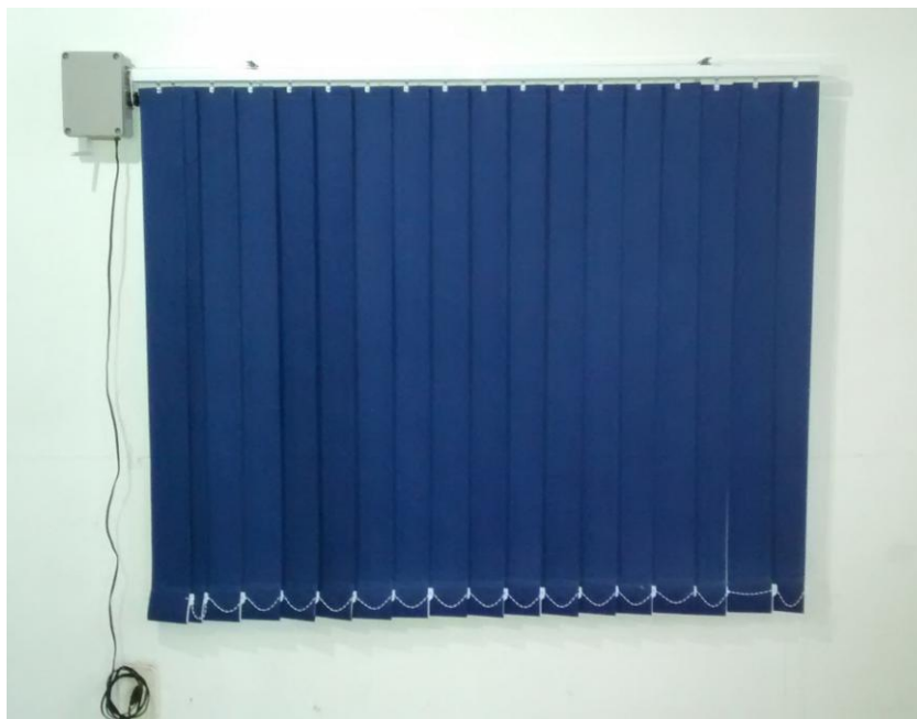
Figura 20 – Persiana Instalada Fonte: Autoria própria
