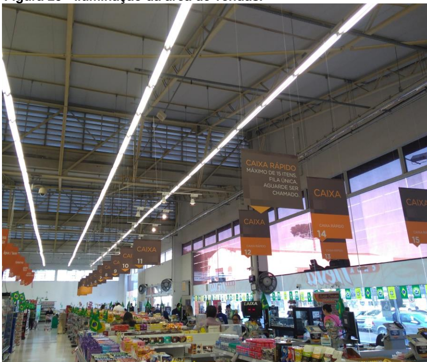
Figura 25 - Iluminação da área de vendas.
