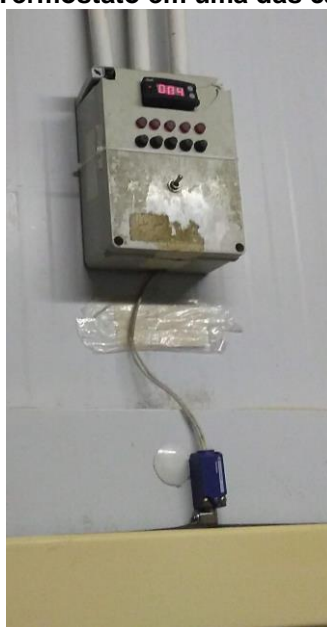
Figura 43 - Termostato em uma das câmaras frias.
