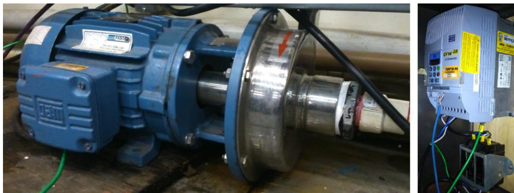
Figura 17 - Bomba centrífuga e o inversor de frequência.
