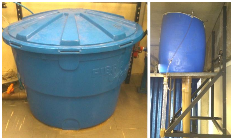
Figura 19 - Reservatório inferior e superior de água.
