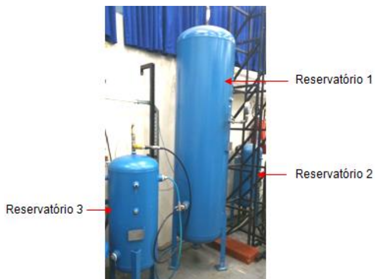
Figura 15 – Reservatórios de ar.
