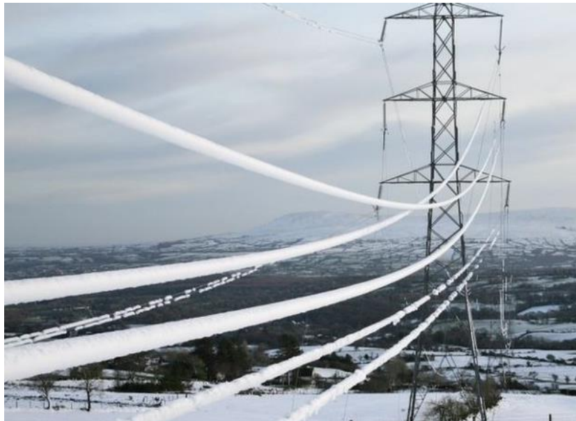
Figura 2.11 - Cabos com gelo acumulado. Fonte: BBC NEWS (2013)
