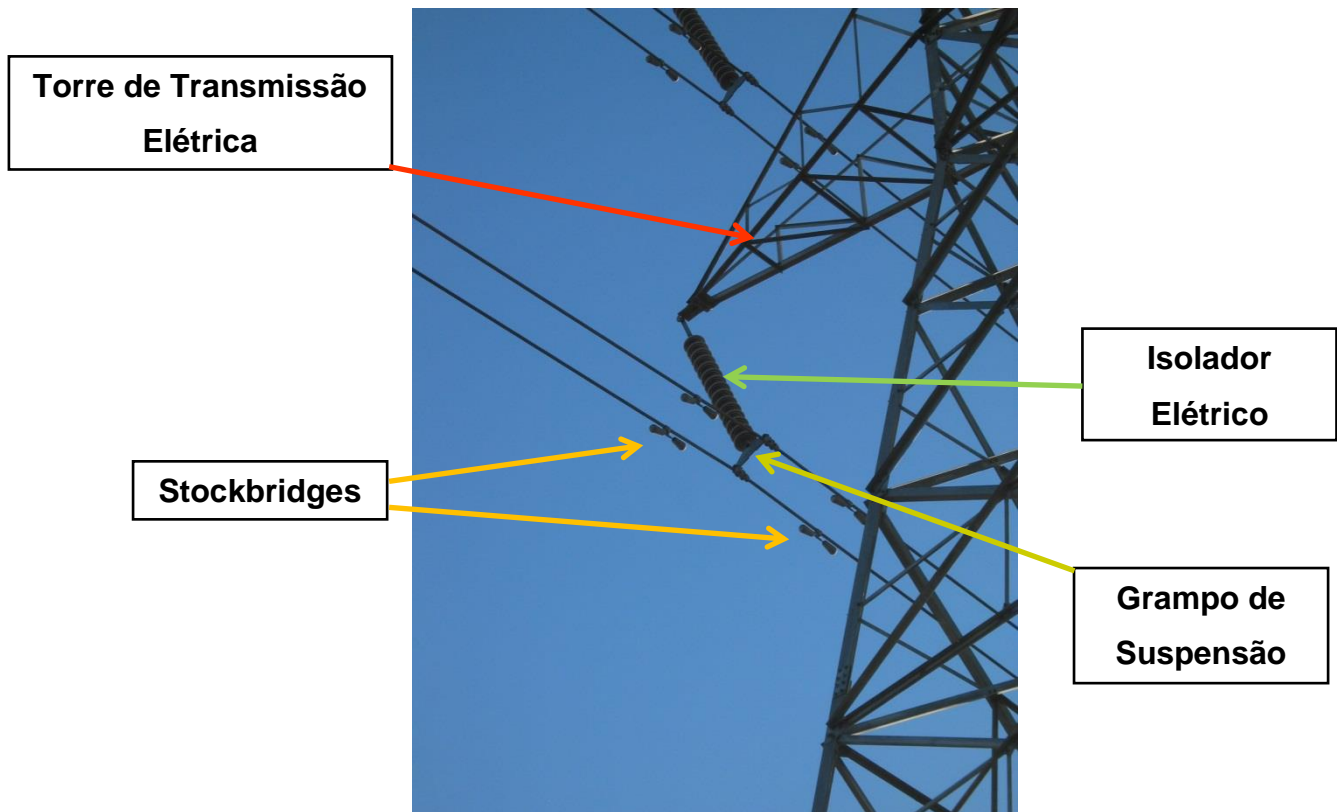
Figura 2.30 - Emprego do stockbridge em linhas de transmissão elétrica. Fonte: VANNUTELLI (2013)
