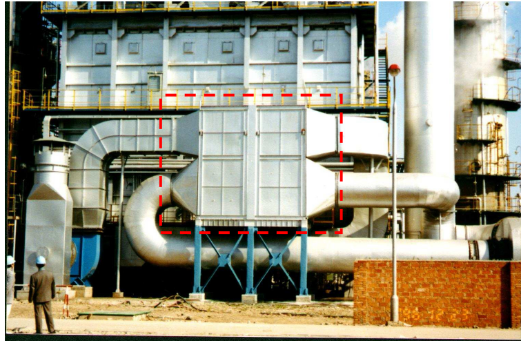
Figura 4. Trocador de calor com termossifão aplicado na indústria.
