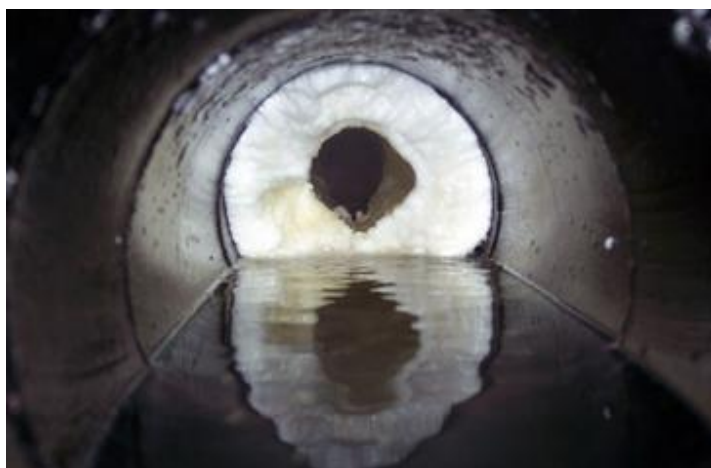
Figura 2: Deposição de hidrato na parede de um oleoduto. (Fonte: http://www.offshoreengineering.com/pipelines/flow-assurance-222/118-pipelines/flow-assurance/156-hydrates ).
