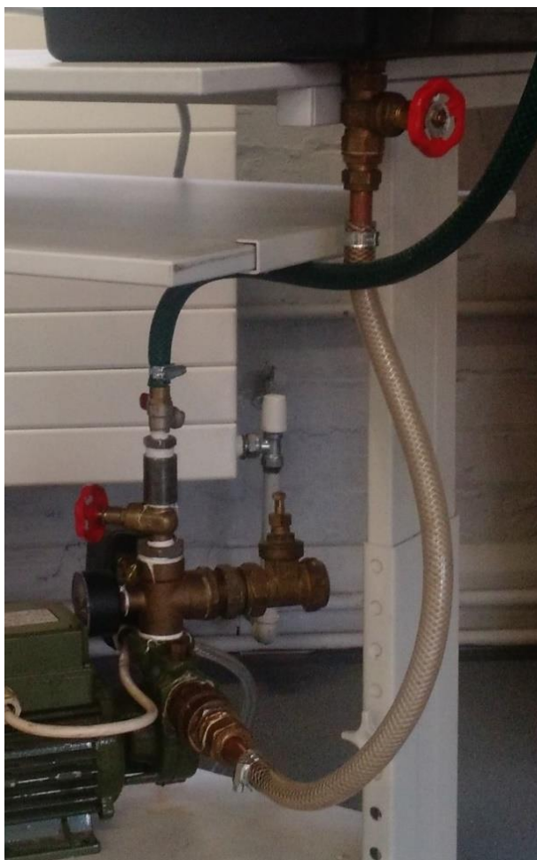
Figura 38 Saída do reservatório conectada à entrada da bomba
