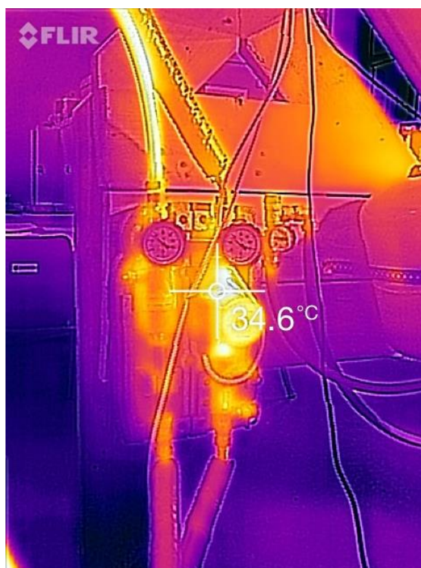
Figura 56 Imagem térmica da estação de bombeamento
