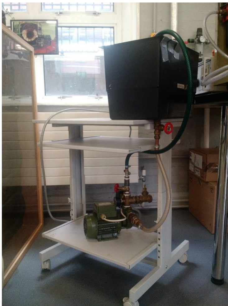
Figura 35 Estação de enchimento
