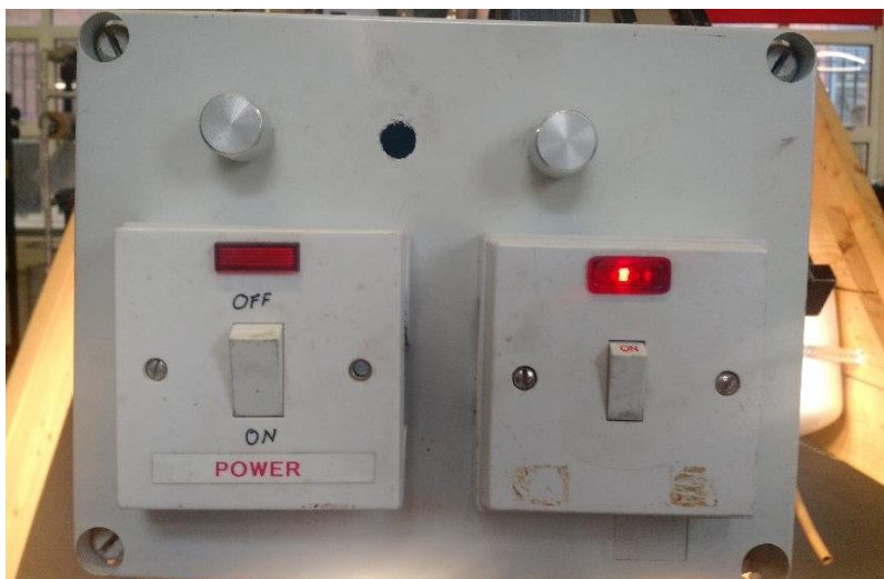
Figura 23 Interruptores da fonte de calor
