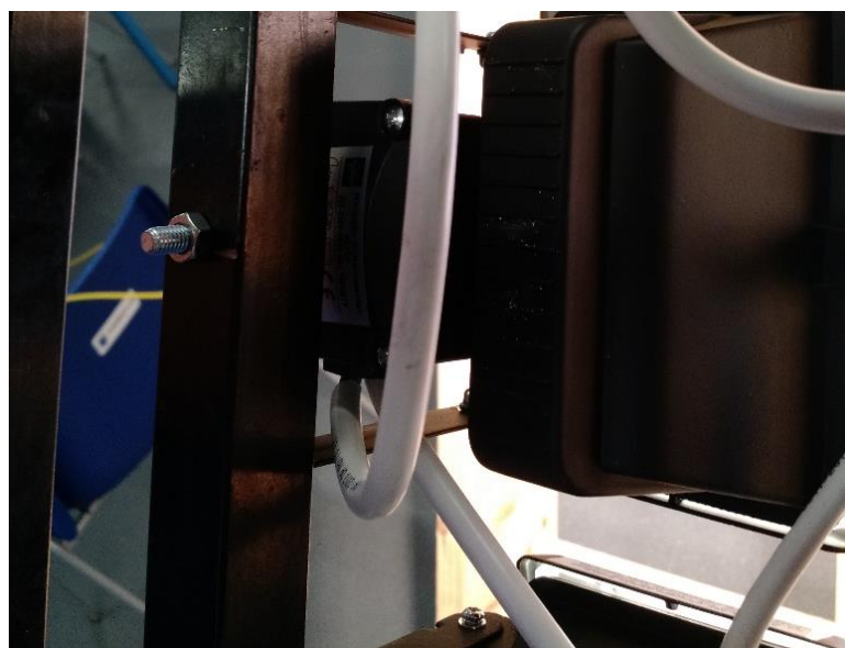
Figura 26 Detalhe da conexão dos holofotes
