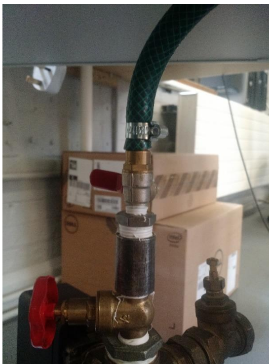
Figura 36 Mangueira de pressão conectada à saída da bomba
