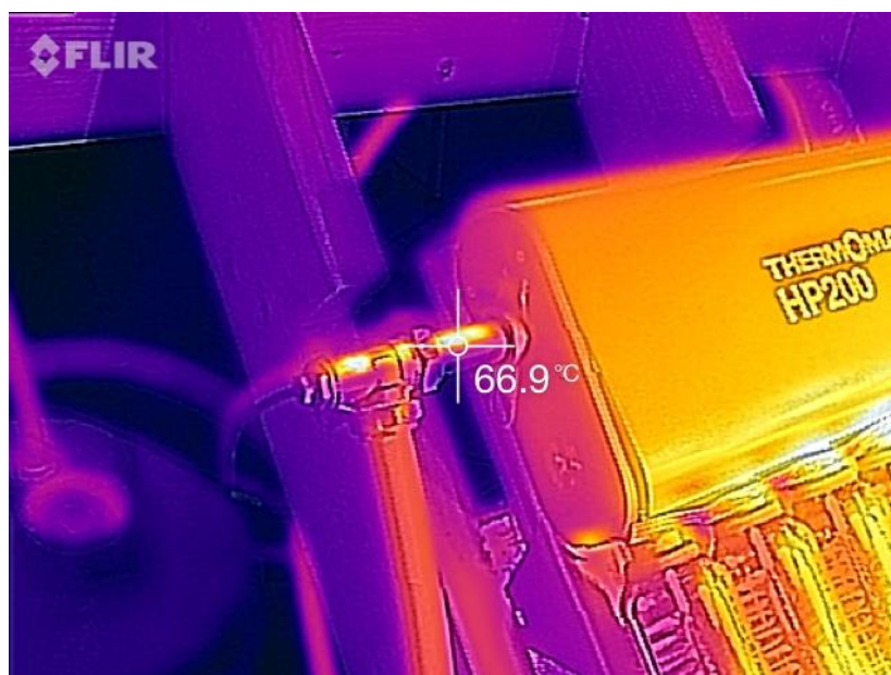
Figura 54 Imagem térmica FLIR da saída do coletor
