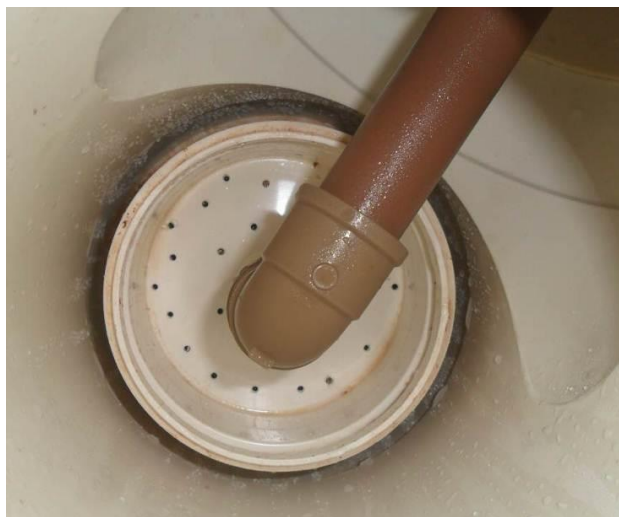
Figura 4.3 - Fotografia do distribuidor de água residuária no topo da torre Fonte: Autoria própria.
