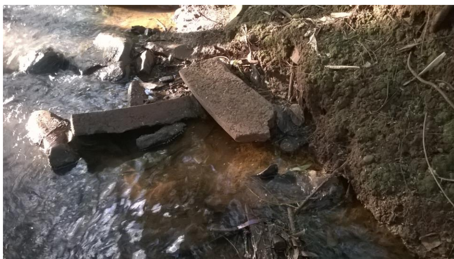
Figura 6 – Riacho urbano com entulho de obras civis em seu leito e visível erosão Fonte: Acervo do autor.
