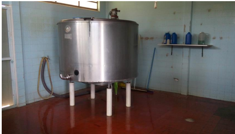
Figura 4 : Tanque de refrigeração do CPRA.
