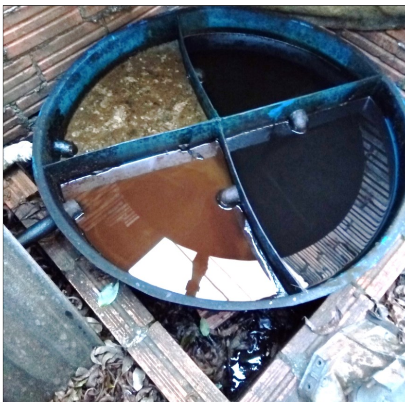
Figura 4 – Separador de água e óleo.
