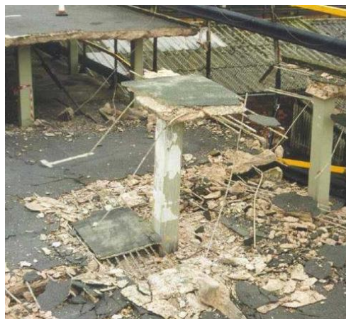
Figura 3 – Ruína causada por punção (Edifício de Garagens em Wolverhampton, Inglaterra, em 1965)
