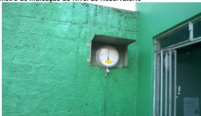
Figura 4– Manômetro de Indicação do Nível de Reservatório
