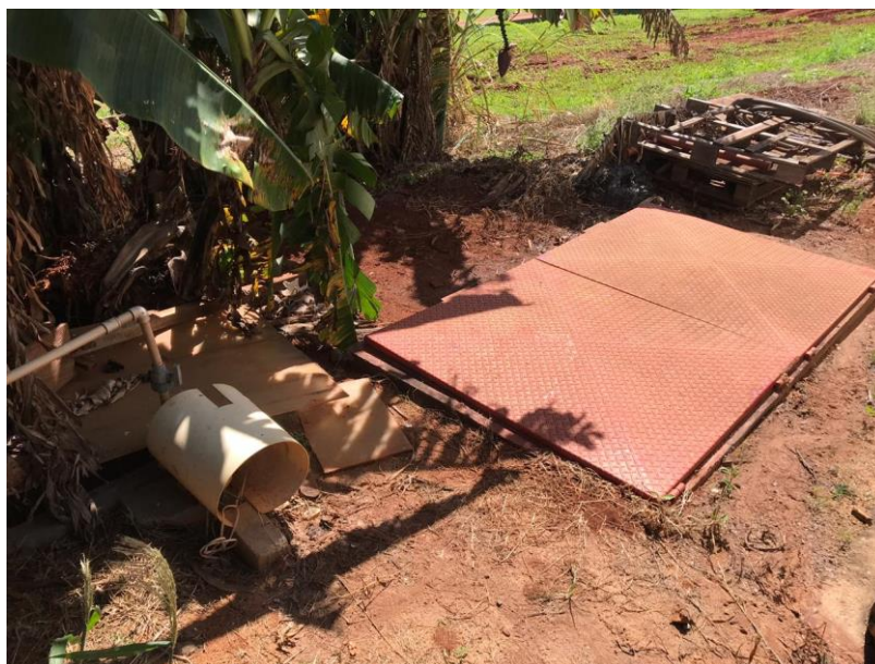
Figura 16 - Sistema de captação do efluente do restaurante universitário
