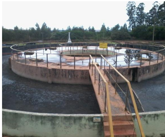
Figura 4 - Reator UASB da SANEPAR.
