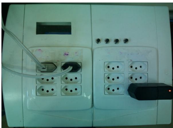
Figura 7 - Painel de controle e automação composto por um time.
