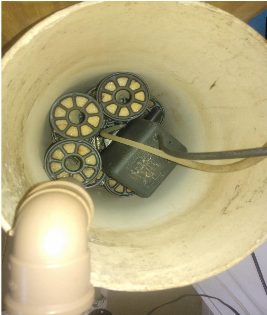
Figura 4 - Fotografia da Moto Bomba Submersa. Fonte: próprio autor.
