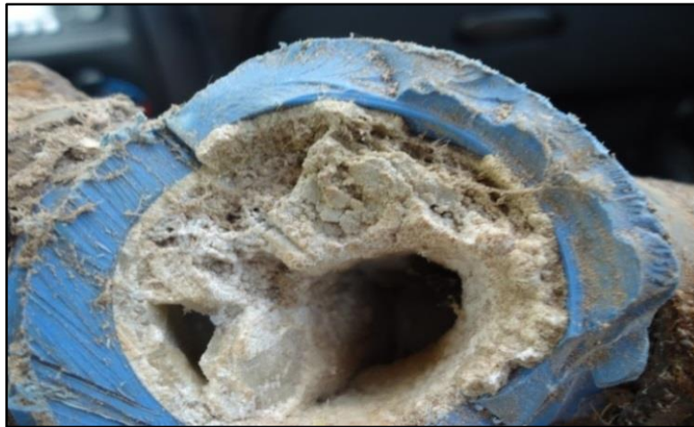
Figura 8 - Foto em detalhe com evidência de incrustação carbonáticas nos tubos internos do poço tubular profundo da propriedade.
