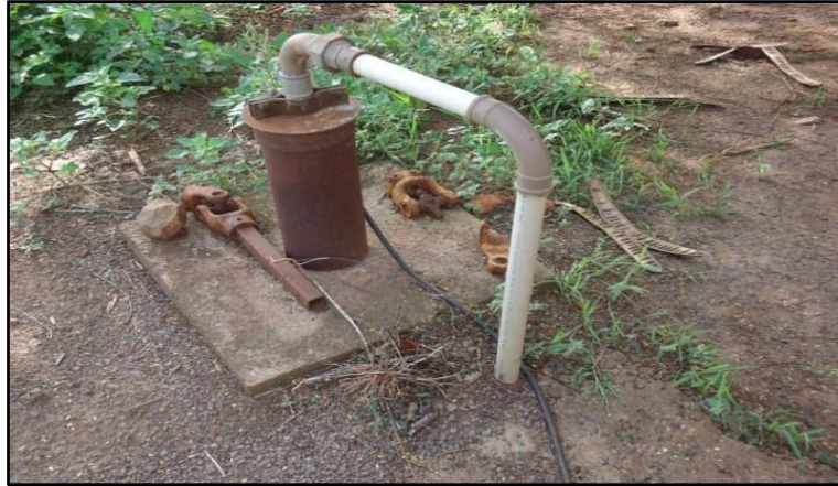
Figura 7 – Foto mostrando poço de captação da água subterrânea do SASG em um sítio em Sabáudia-PR.
