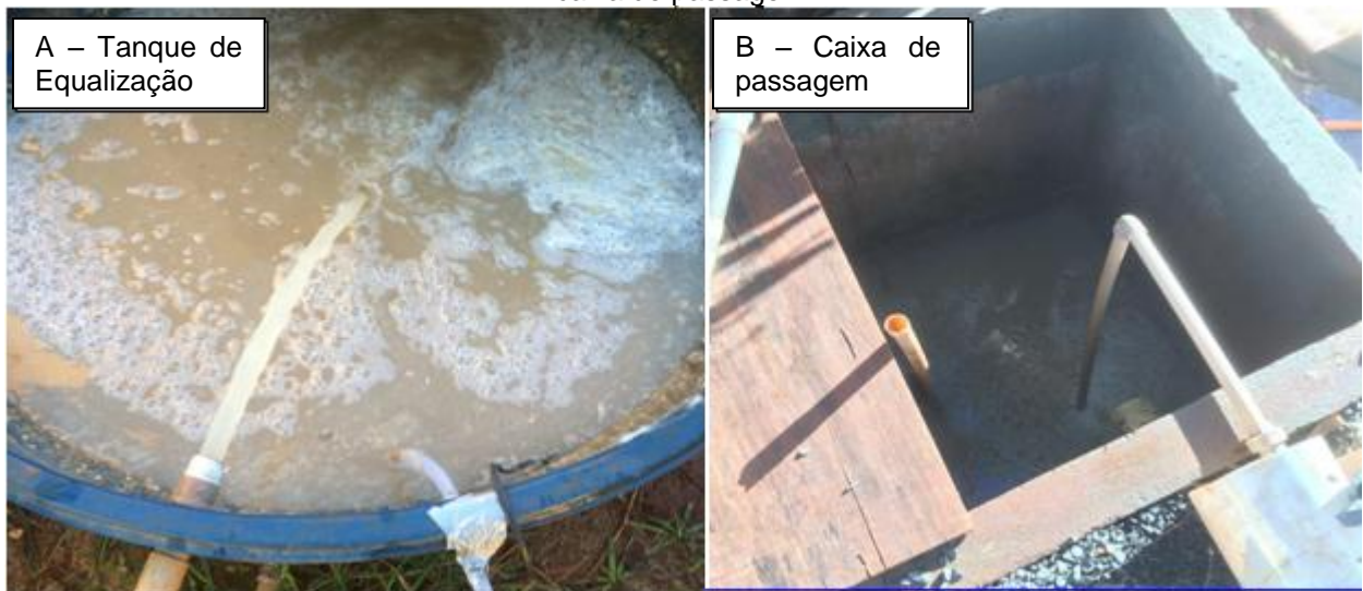
Figura 6: A) Fotografia da vista superior do tanque de equalização; B) Fotografia da vista superior da caixa de passagem.
