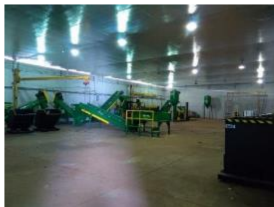
Figura 26. Linha de processamento de plásticos da CVMR-LD Fonte: Próprio autor
